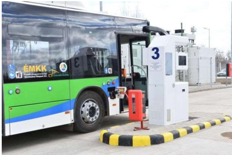
12. ábra – CNG töltőállomás
